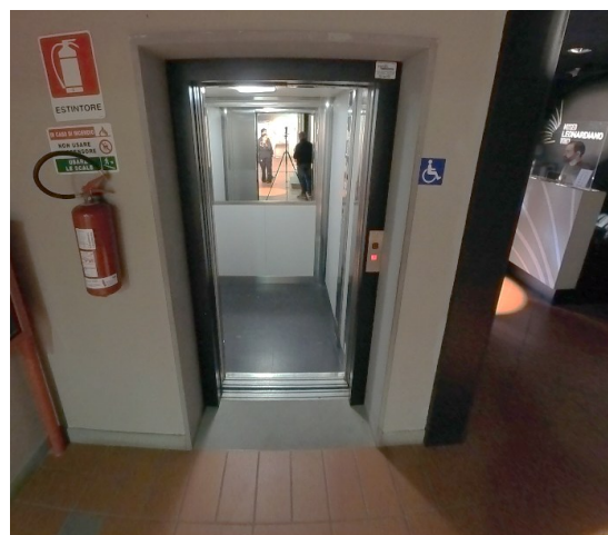
10 ascensore dentro Palazzina Uzielli
